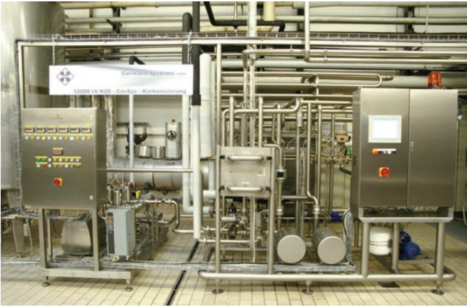
Die neue Karbonisieranlage (links) mit einer Stundenleistung von 12 000 l, rechts daneben KZE, Steuerung und Touchpanel
